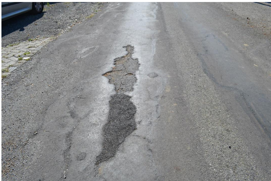
Fissures, nid-de-poule (gel/dégel, véhicules lourds, usure, fondation insuffisante)
