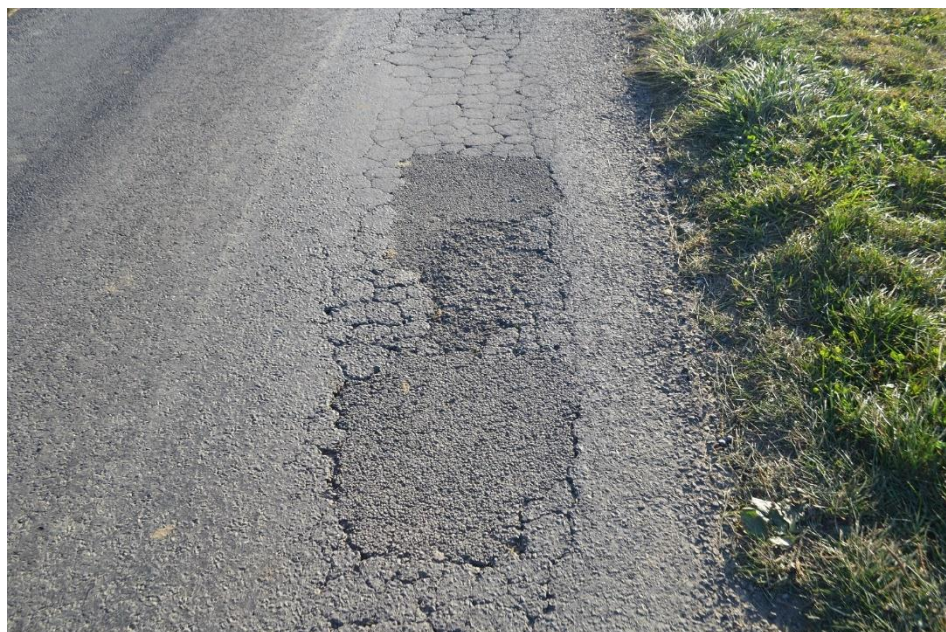
Fissures et nids-de-poule (gel/dégel, véhicules lourds, usure et fondation insuffisante)
